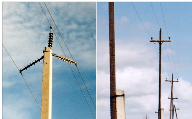
Безопасные для птиц опоры ЛЭП. Фото А. Салтыкова Bird-friendly power poles. Photo by A. Saltykov
